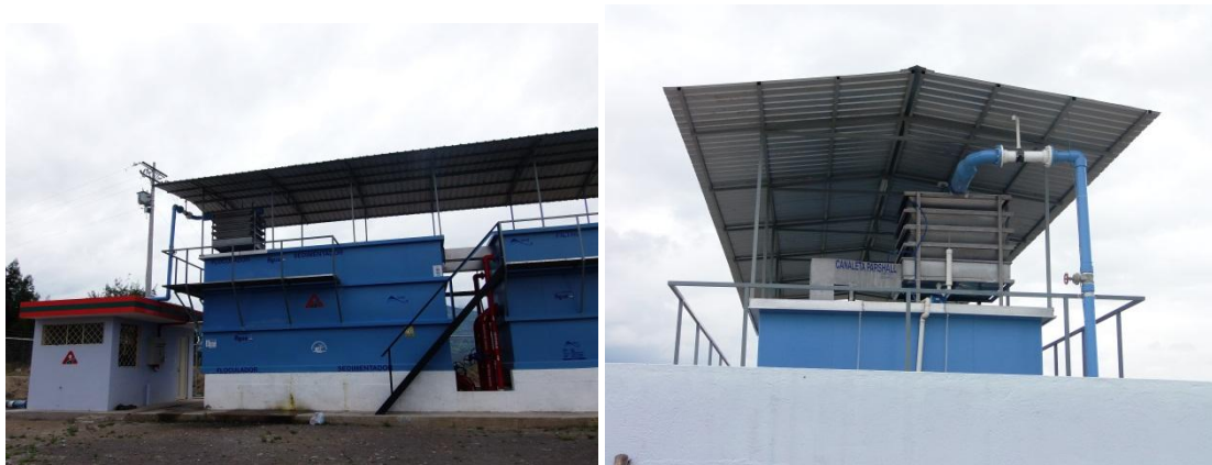
FIGURA 5 Planta de tratamiento de Agua Potable para Totoras.
